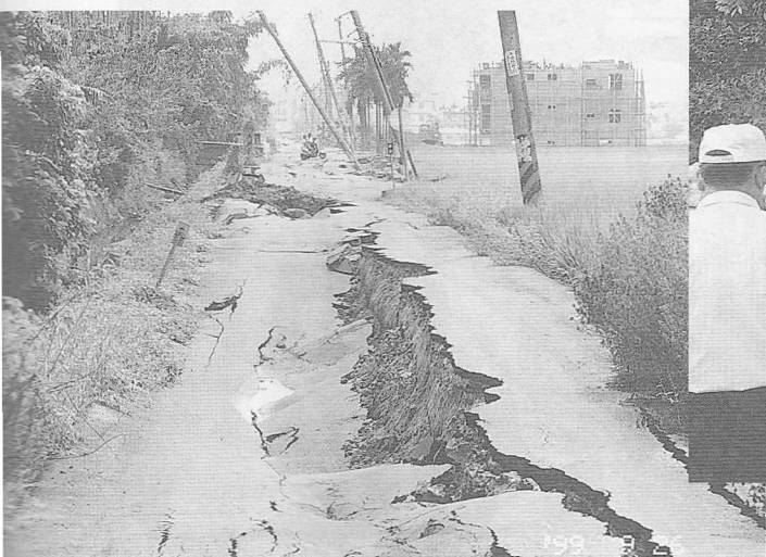
△地處斷層帶上，道路嚴重龜裂。
