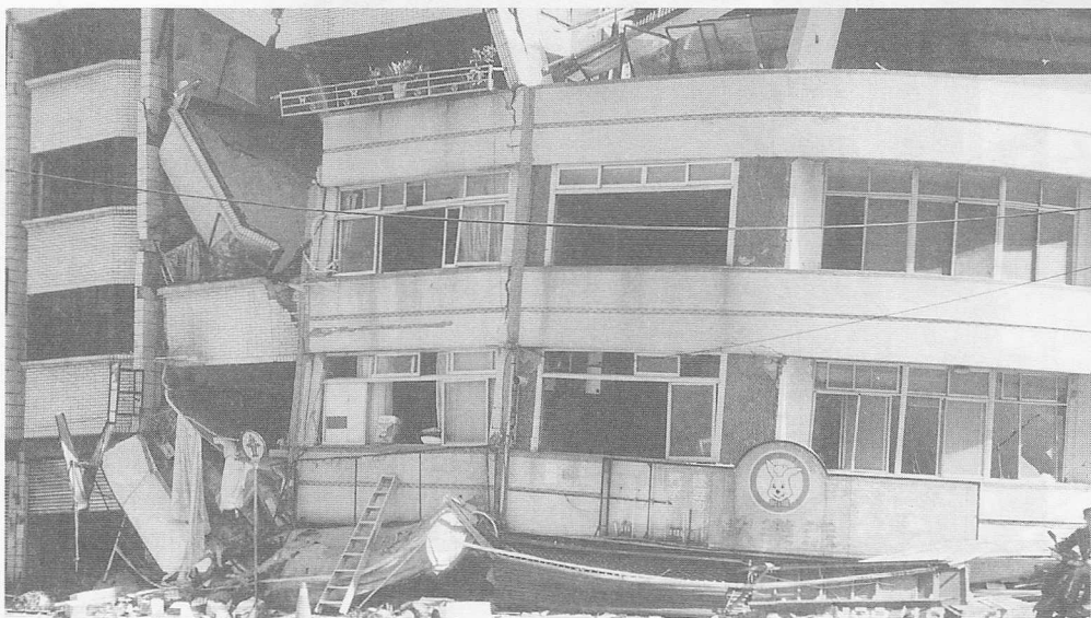
△房屋震毀，一樓不見了。
