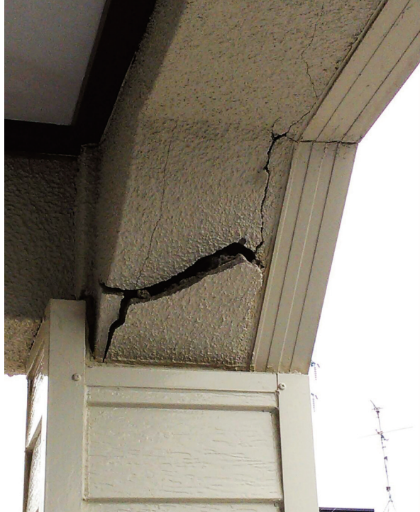
▲ 強震來襲，中山壇主家入口處的梁柱也嚴重地崩裂。
